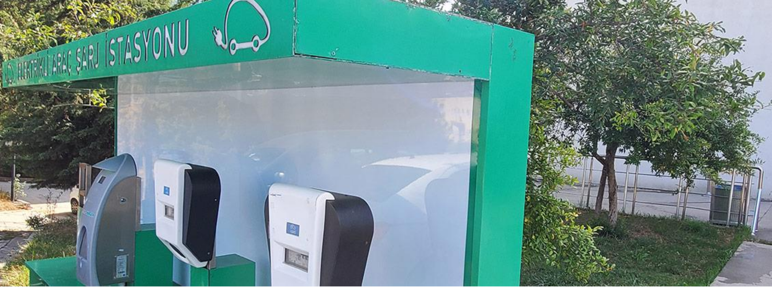
Elektrikli Araç Şarj İstasyonu
